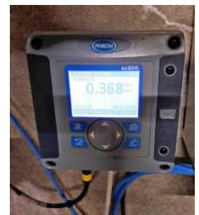
Transmetteur dans le local de captage
