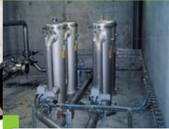
Stérilisation ultraviolette à Gresse-en-Vercors
