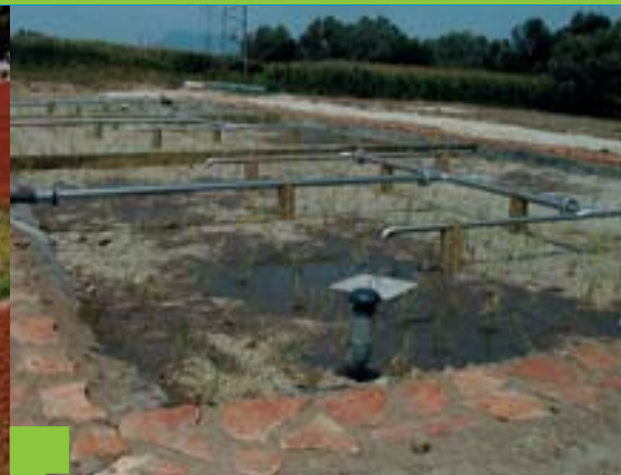
Station d'épuration par lits filtrants plantés de roseaux - Chimilin
